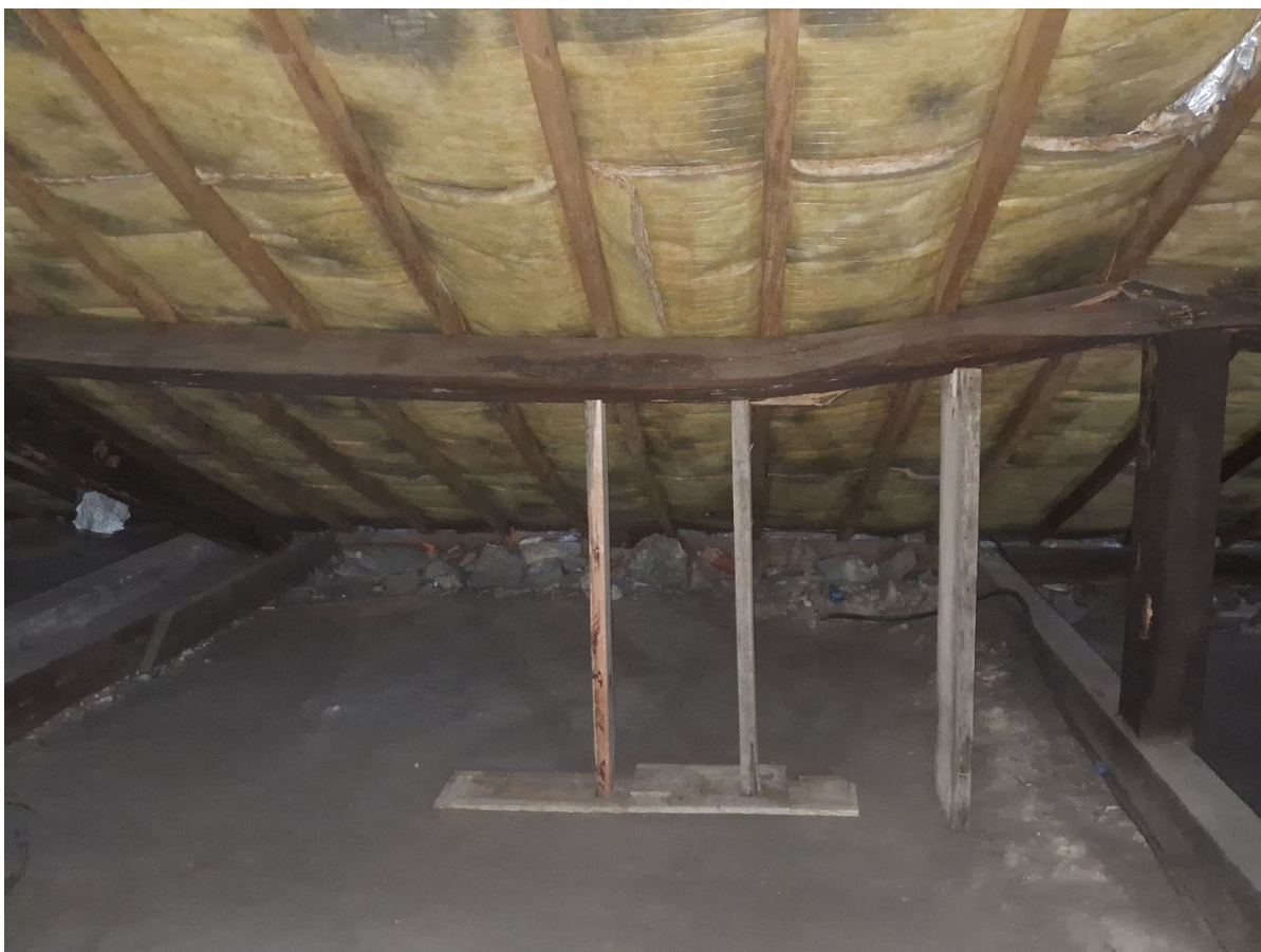
Detalhe de uma terça do telhado que trincou e cedeu por conta de ataque de insetos xilófagos e umidade.
